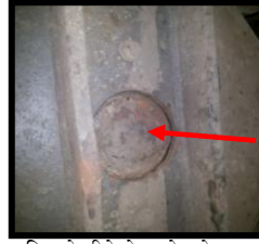
सेन्द्रल पिन के नीचे वेस प्लेट से टकराने के कारण आया हुआ उठाव
